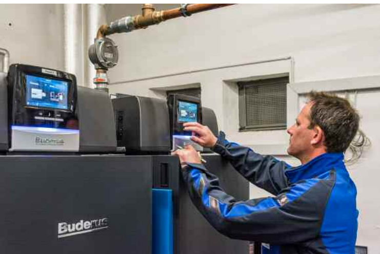
Der technische Kundenbetreuer Herr Wolf bei der Kontrolle einer zentralen Heizungsanlage
