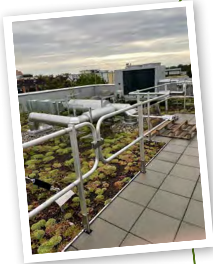
Exemplarisch: Wärmepumpen-Außeneinheiten im Masurenweg 9
