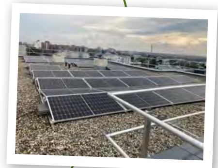
Photovoltaikanlage auf einem unserer Bestandsgebäude
