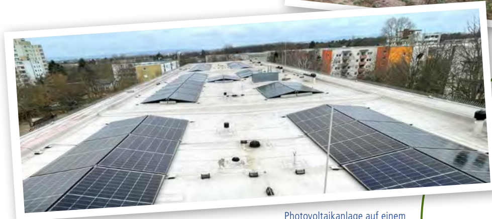
Photovoltaikanlage auf einem unserer Gebäude im Hessenring
