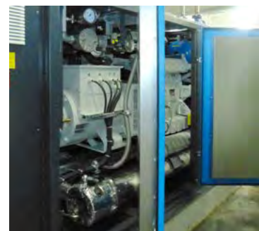
Eins unserer Blockheizkraftwerke
