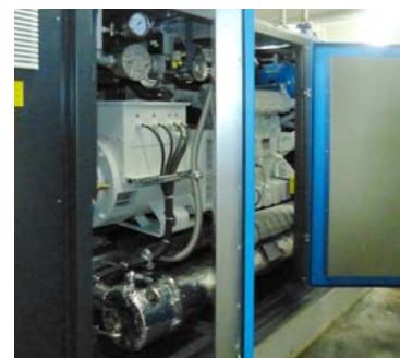
Eins unserer Blockheizkraftwerke
